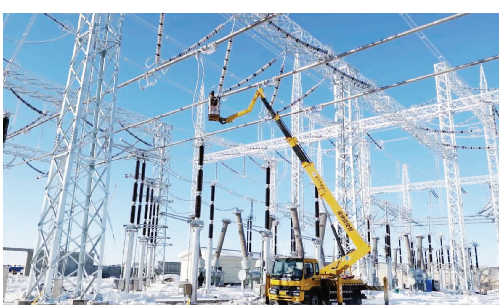
内蒙古能源集团送变电公司察右后旗500千伏变电站工程施工人员正在进行管母线附件安装
