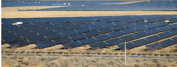
达拉特旗的光伏发电基地
