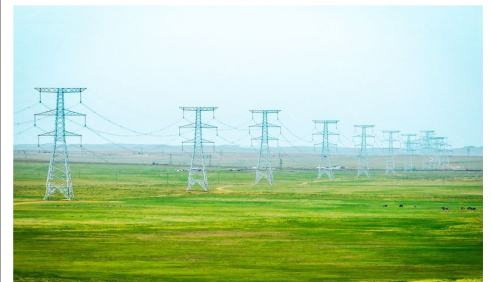
6500千伏“包风2”输变电工程输电线路
