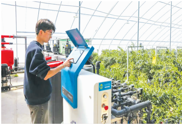
调控水肥一体化自动灌溉系统
