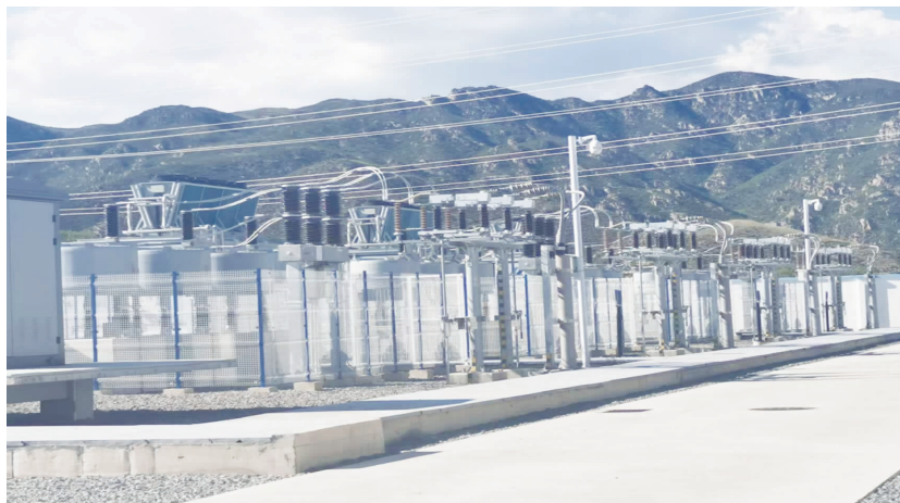
“全国一体化算力网络”和林格尔数据中心集群绿色能源供给示范项目升压站
